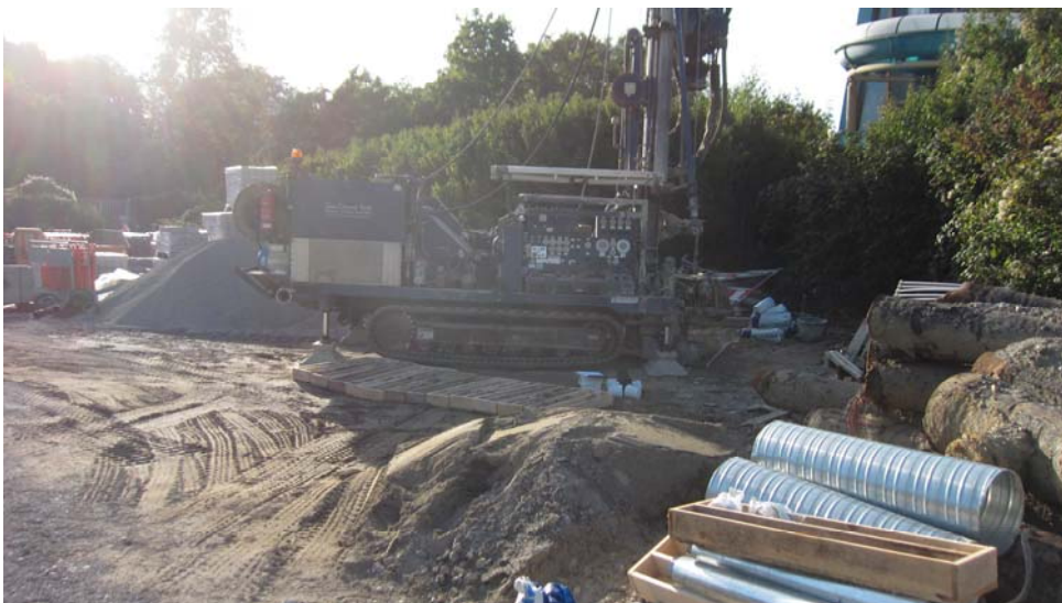
Foto: Bohrung an Ansatzpunkt BK 2 im geplanten Baufeld. Die Zugänglichkeit war durch die Nutzung des Geländes als Baustoff- und Reststoffzwischenlager erschwert
