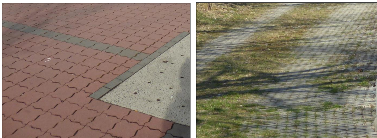
Abbildung 1: Wasserdurchlässige Beläge der Parkierungsflächen und der Anlieferzone
