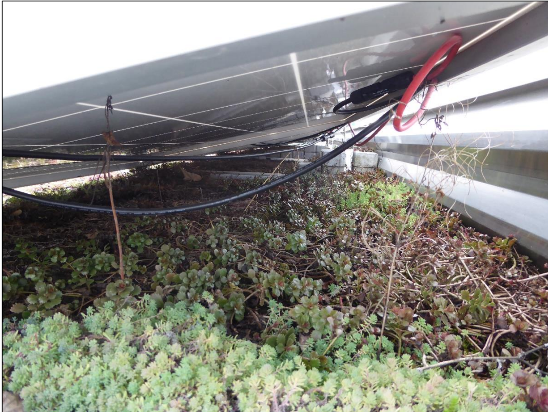
Abbildung 5: Dachbegrünung unter Photovoltaikanlagen
