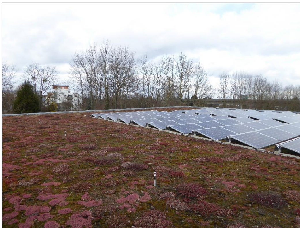
Abbildung 4: Gründach mit Photovoltaikanlagen
